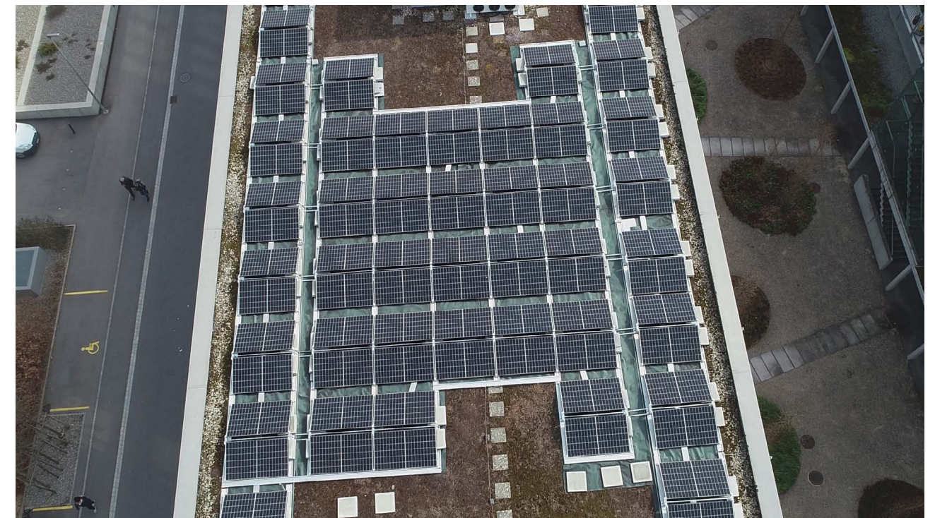
Die Photovoltaikanlage auf dem Bürogebäude der AGV wurde 2020 in Betrieb genommen. (Bild: Goldenberger Elektro AG, Remo Hauri)
